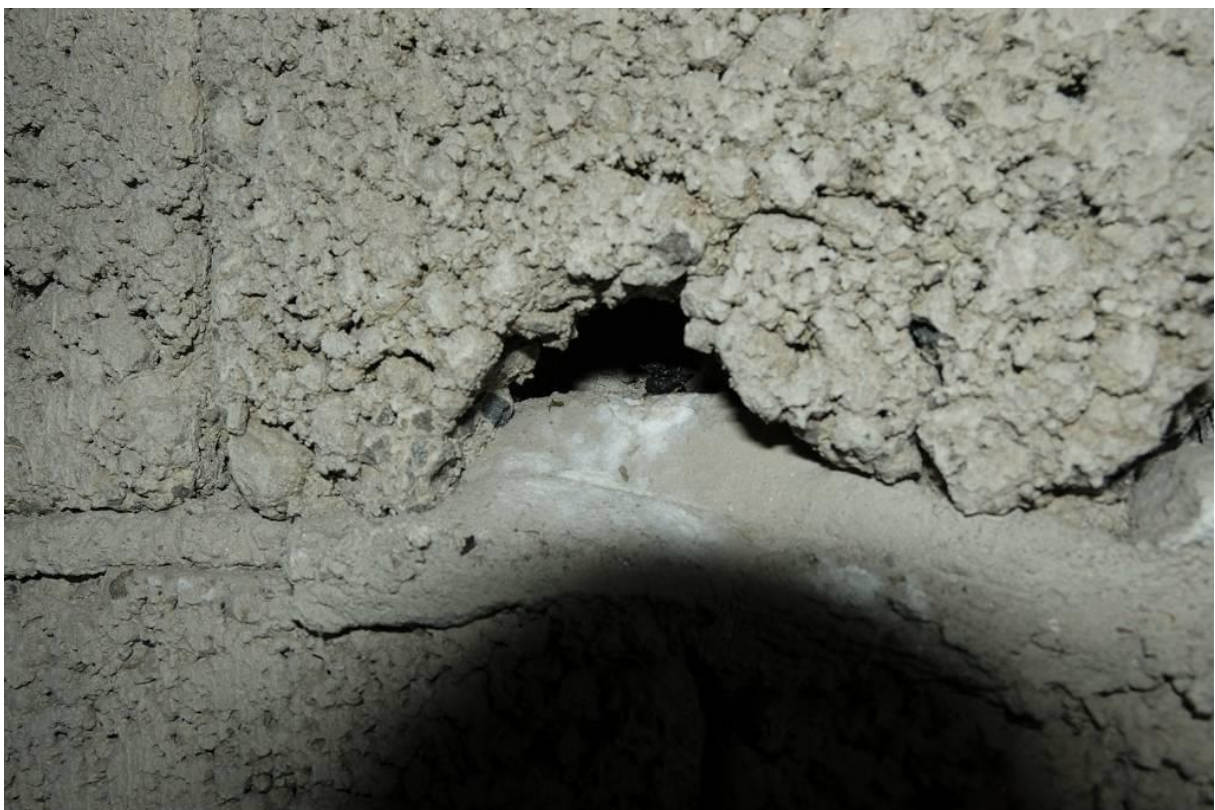
Abbildung 46 Hohlblockstein mit Einschluöffnung und Fledermauskot
