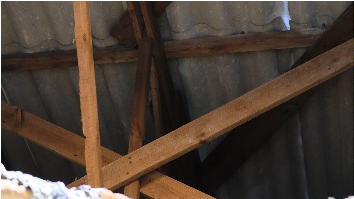
Abbildung 20 Blick durch die beschädigte Decke auf die Dachkonstruktion Gebäude Nr.7
