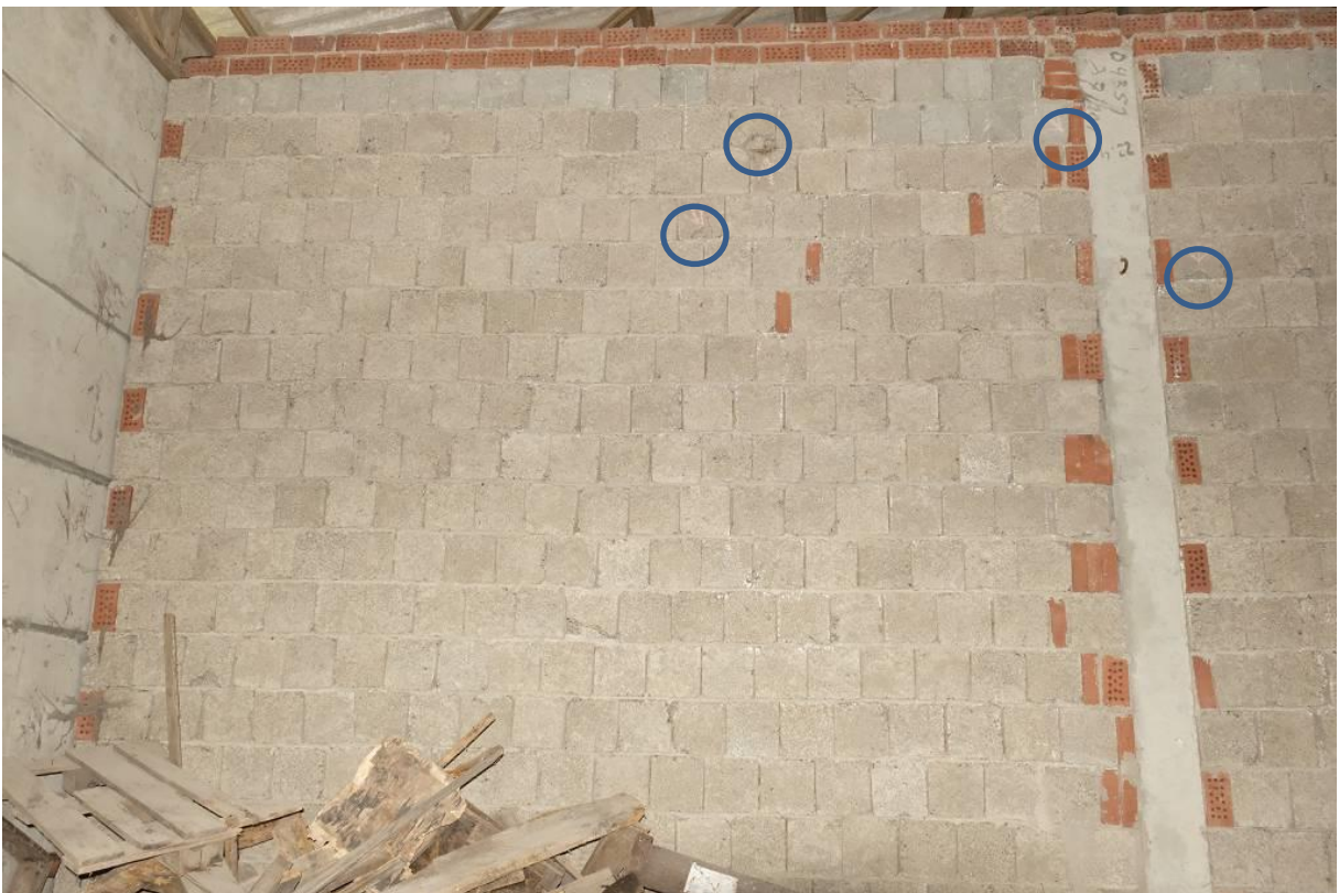
Abbildung 48 Trennwand in Haus 6 (linke Seite) mit Fledermausquartieren (Kreis)
