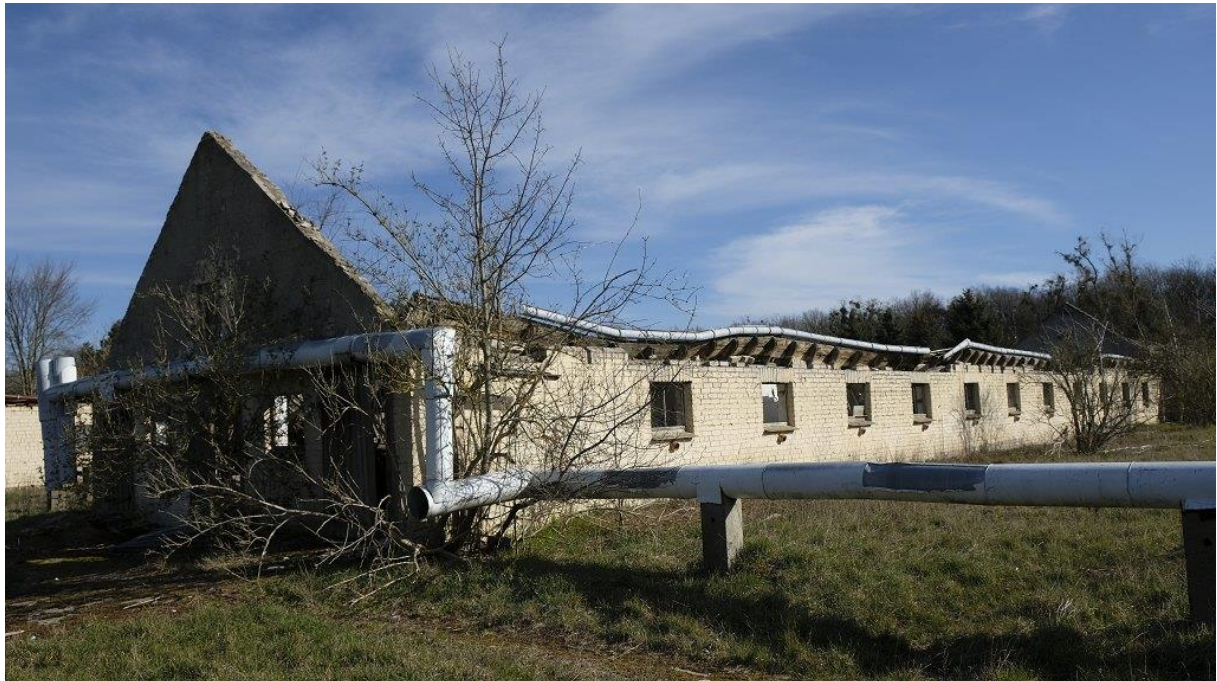
Abbildung 23 eines der eingestürzten Gebäude
