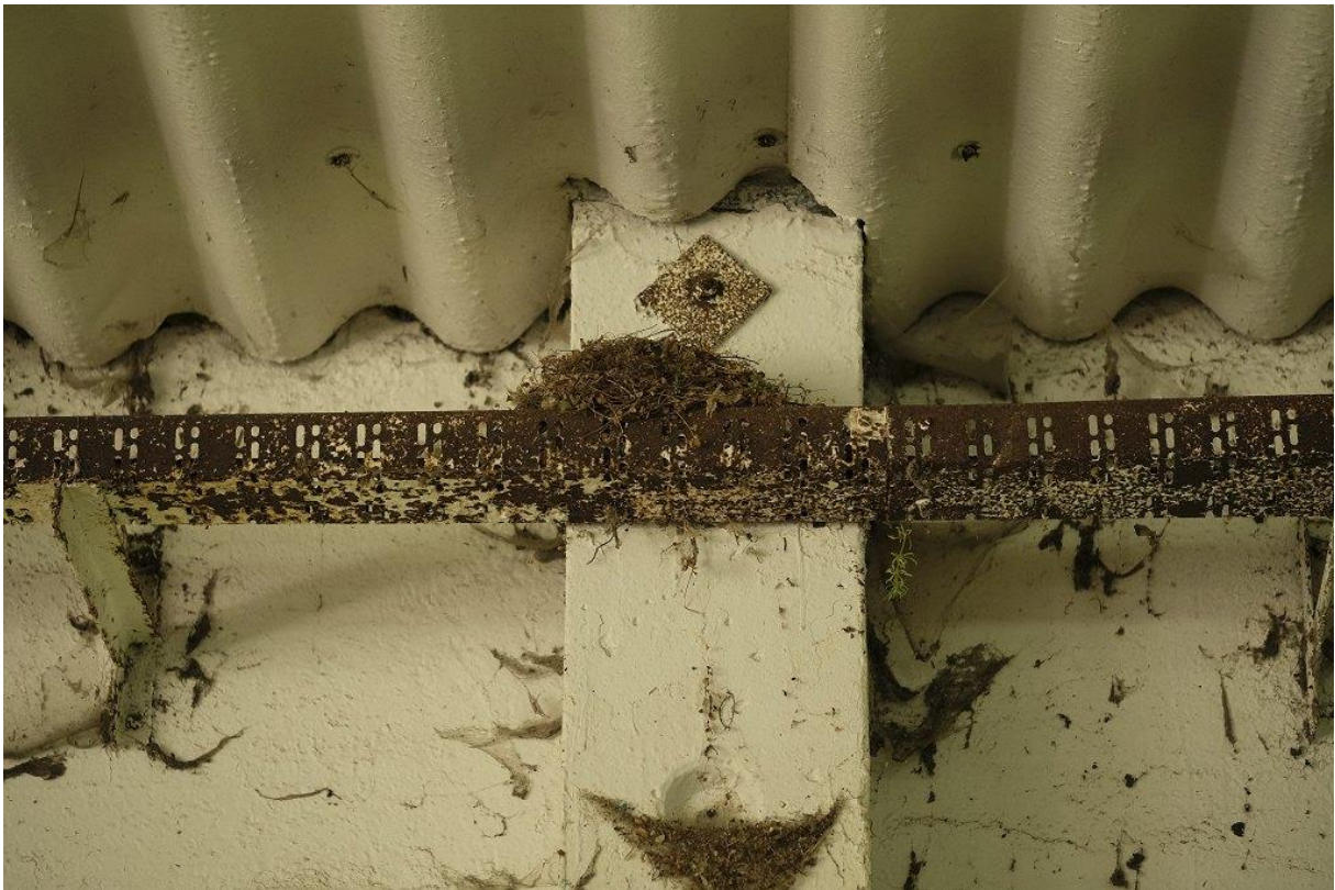
Abbildung 27 Nest vom Hausrotschwanz auf Kabelkanal
