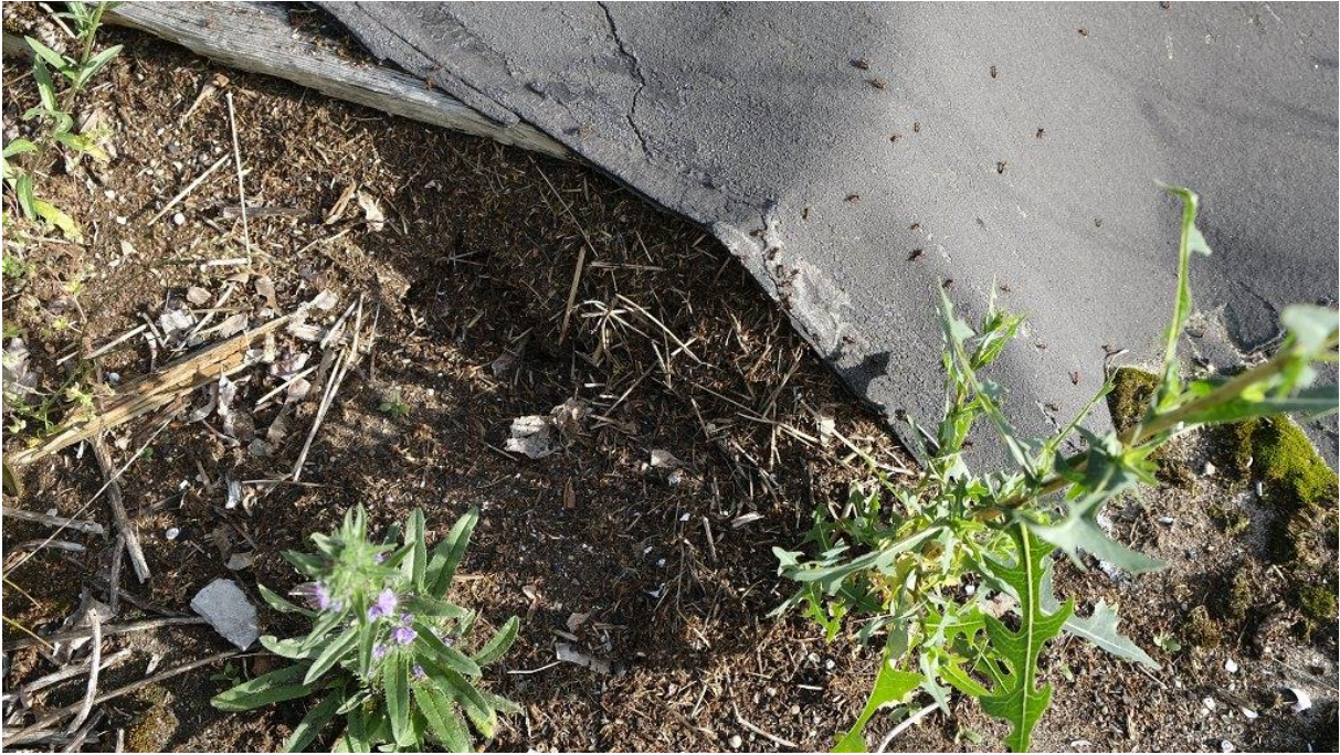
Abbildung 36 Nest von Waldameisen teilweise unter einer Dachpappe
