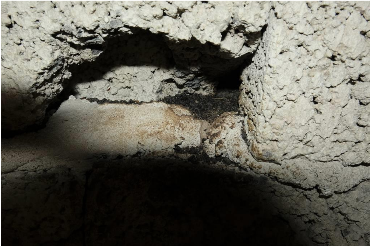
Abbildung 45 Hohlblockstein mit Einschluöffnung und Fledermauskot
